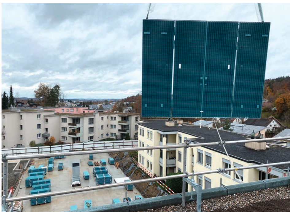
Mit dem Kran fertig vorkonfektioniert an den Zielort. Des éléments préfabriqués installés grâce à une grue.
